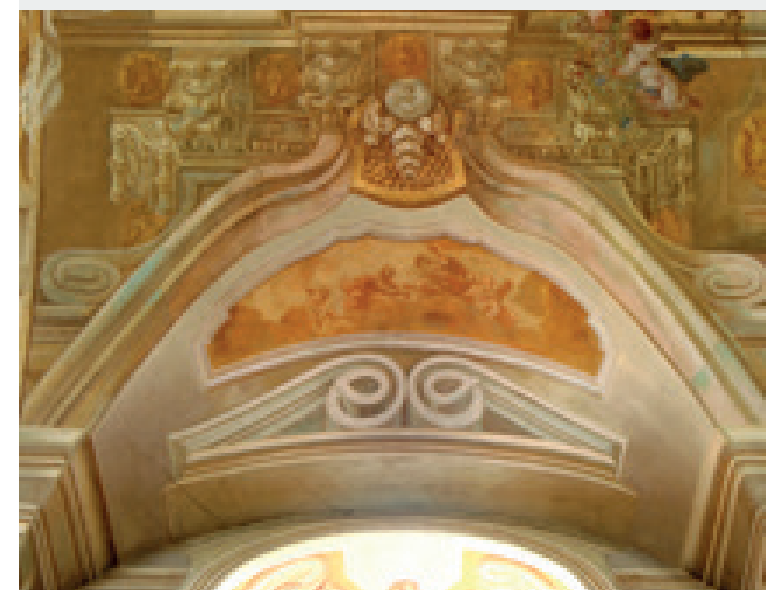
Detail špalety okna před restaurováním
