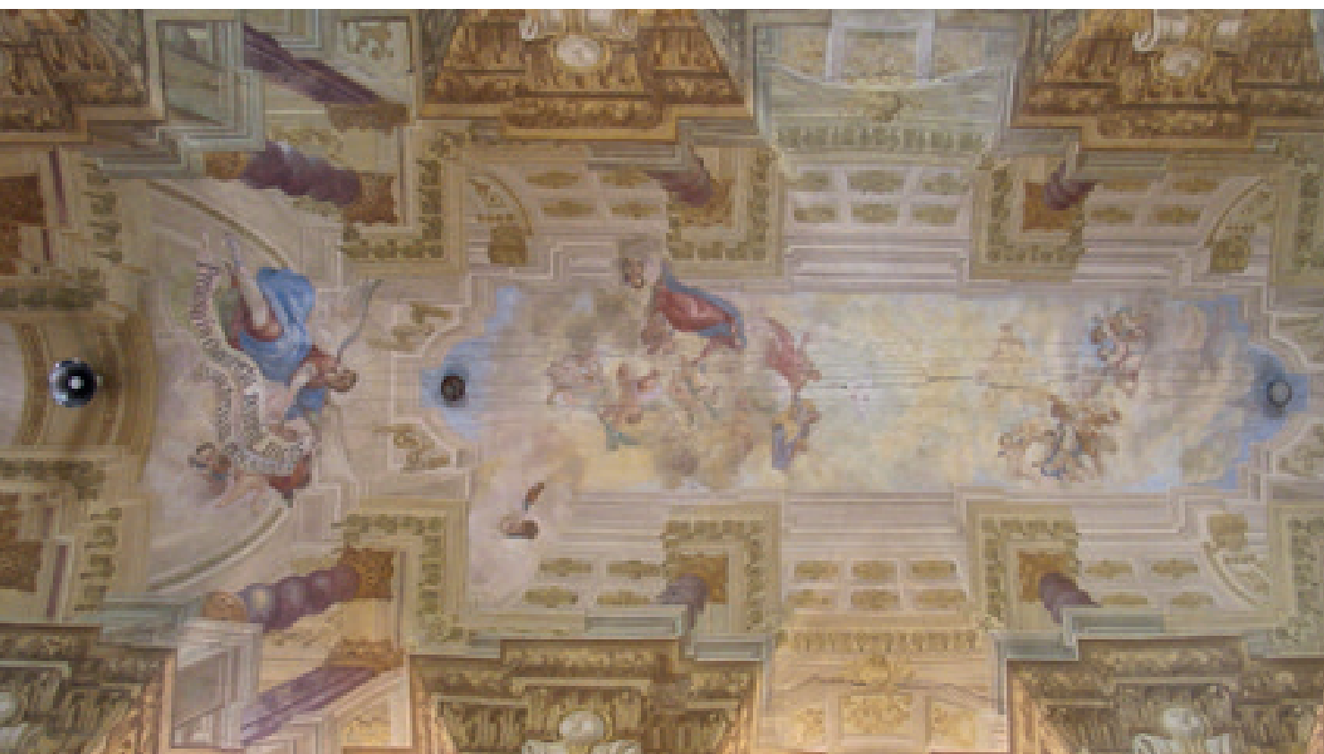
Původní stav klenební fresky v hlavní lodi se statickou poruchou v ose klenby
