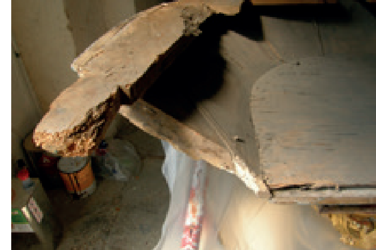
Detail poškození schodiště kazatelny červotočem
