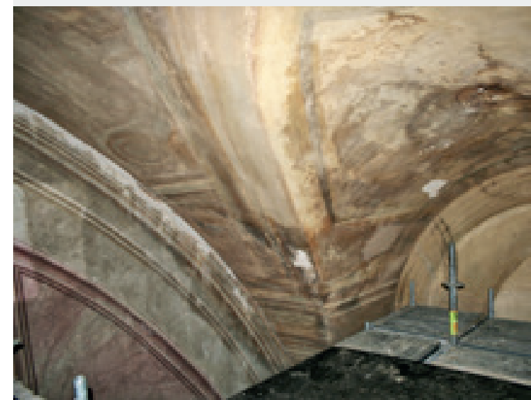
Detail klenebního náběhu před restaurováním
